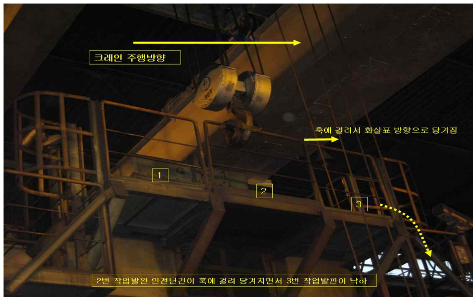
<사진 1 : 재해발생 상황(작업발판 낙하 전)>
