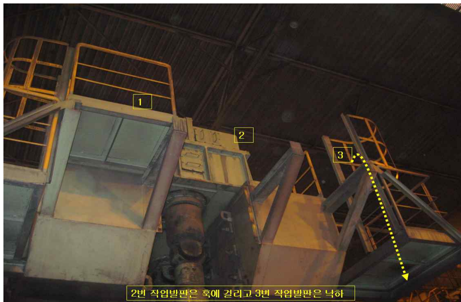
<사진 2 : 작업발판 낙하 후>
